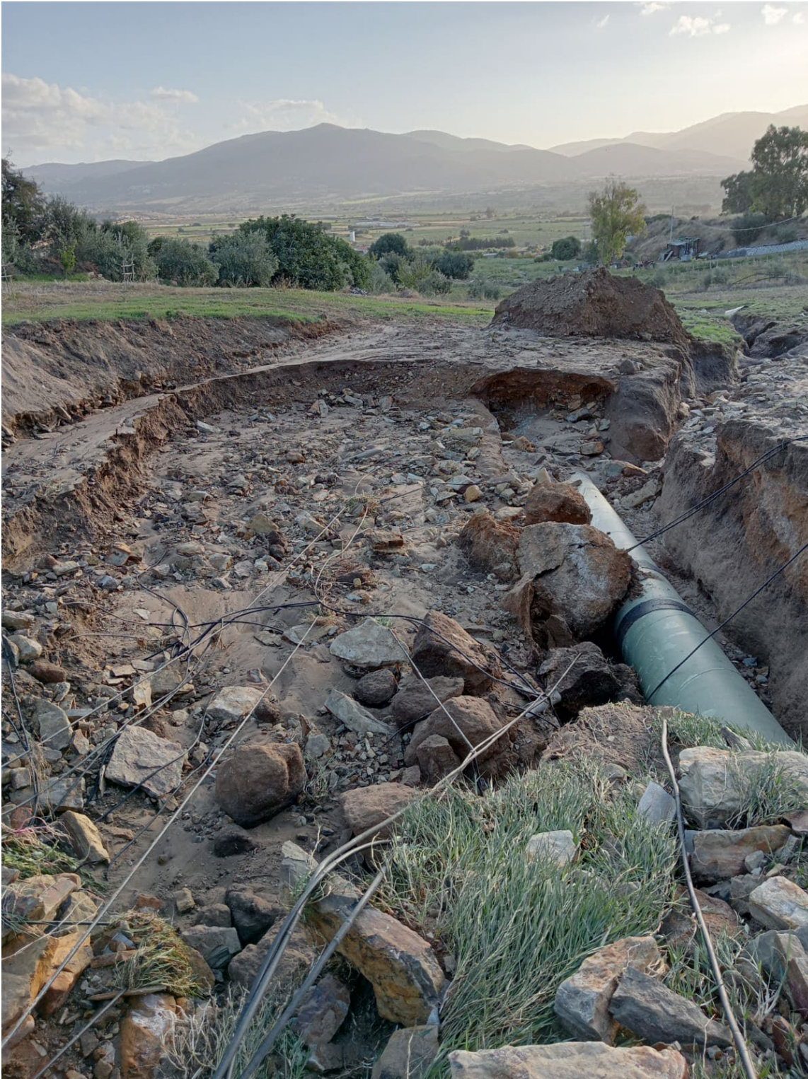
Foto 5 - Particolare delle aree dopo la rottura del 24.09.2023
