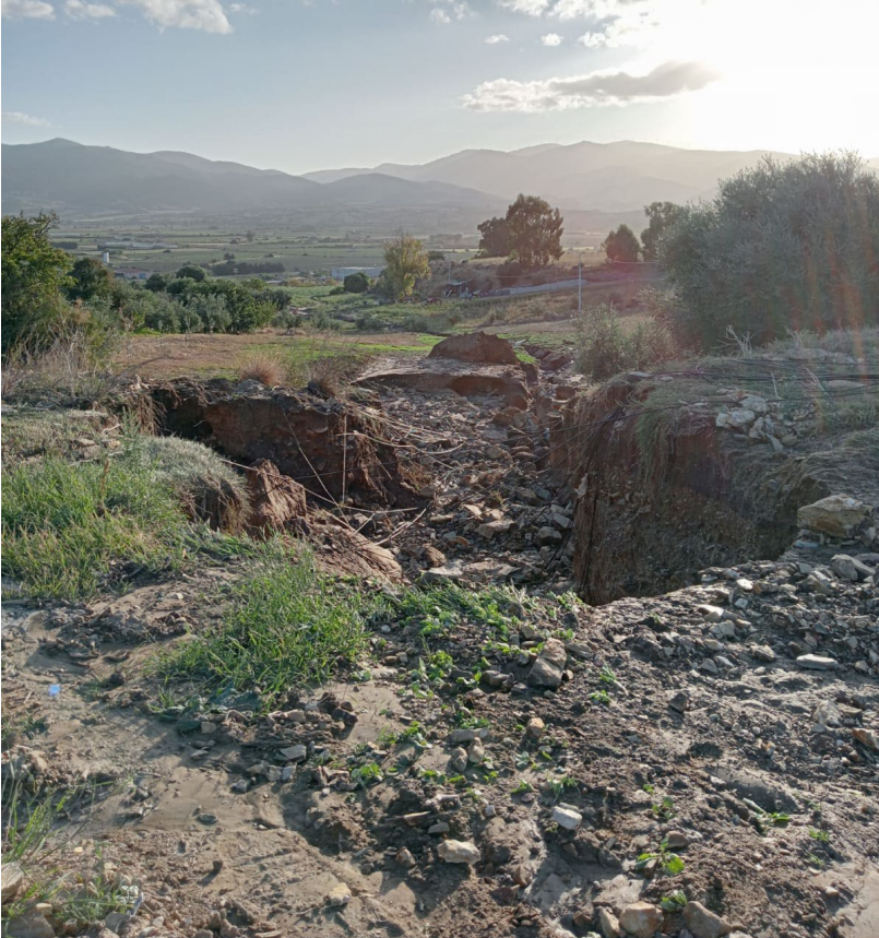
Foto 4 - Particolare delle aree dopo la rottura del 24.09.2023
